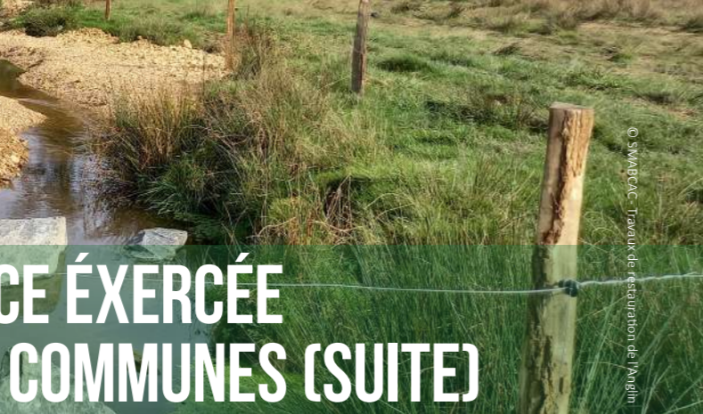
SMPBC - Avant travaux, encoche d'érosion
